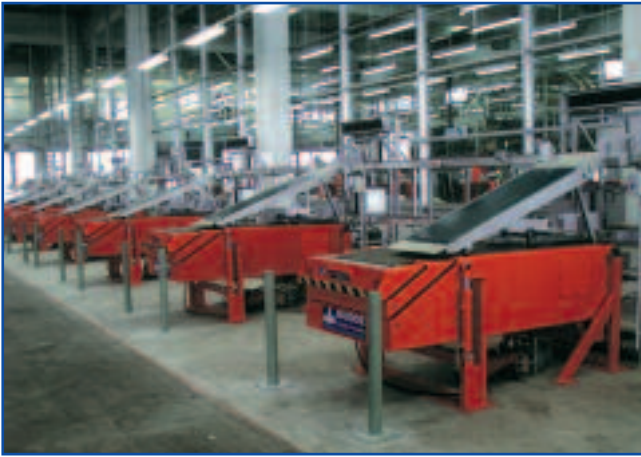
TGF 2,3 - 4,8 im Zeitungsverlag, eingefahren
